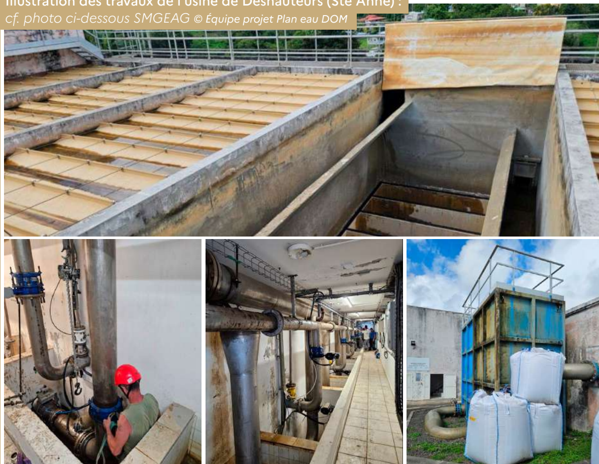
Filtre n°4 / Intervention sur le siphon / Chambre sortie filtres à sables / Stock de sable
